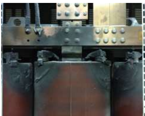
Рис. 3. Последствия пробоя изоляции обмоток 22 кВ.
